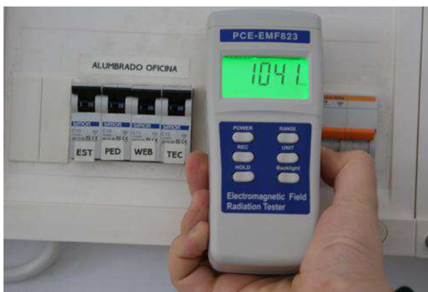
Comprobación de la radiación magnética en un cuadro eléctrico con el gaussímetro.
